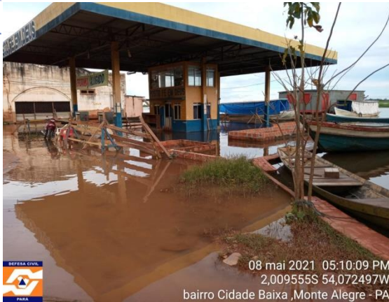
Posto de combustível com reforma de enfrentamento comprometida
